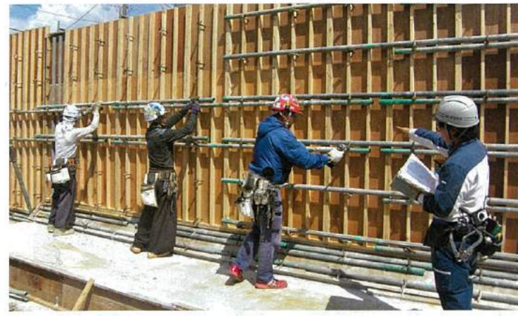
湯浅建設の現場。30代の1級建築施工管理技士などをヘッドハンティングで採用した
